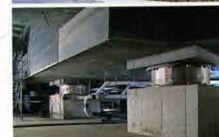
上：南棟の足下を見る。上部構造と免震部分の間には水平なスリットが設けられ、エントランスなど歩行部分にはエキスパンションジョイントとなっている。 下：免震ピット。
