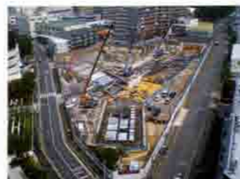
施工中の様子。敷地の形状に対してY字の配置。プレキャストコンクリートの使用などにより工期を1カ月短縮。
